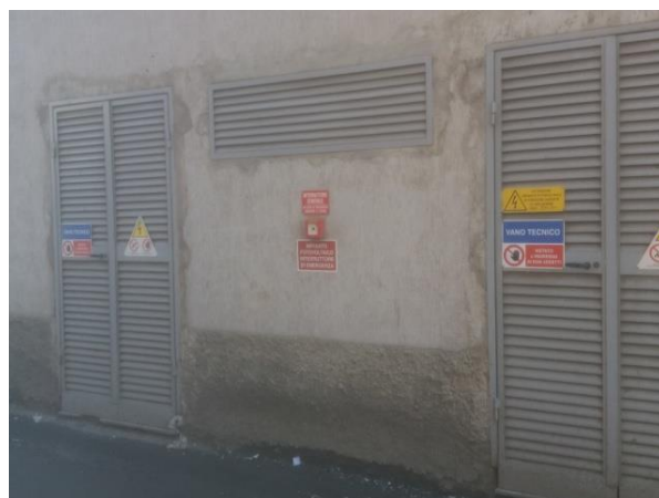
Figura 4- Pulsante sgancio impianto fotovoltaico
